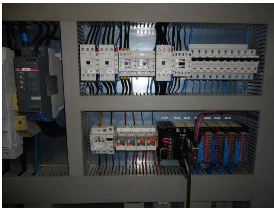
Zdjęcie 4 Sterownik PLC i Soft start napędu przenośnika płytowego
