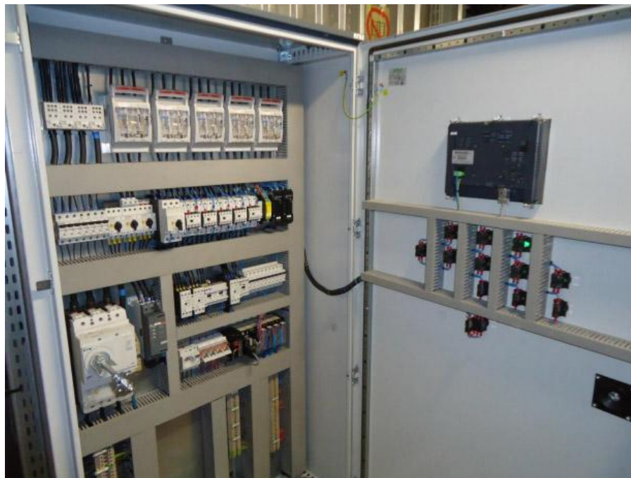
Zdjęcie 1 Widok szafy głównej w środku
