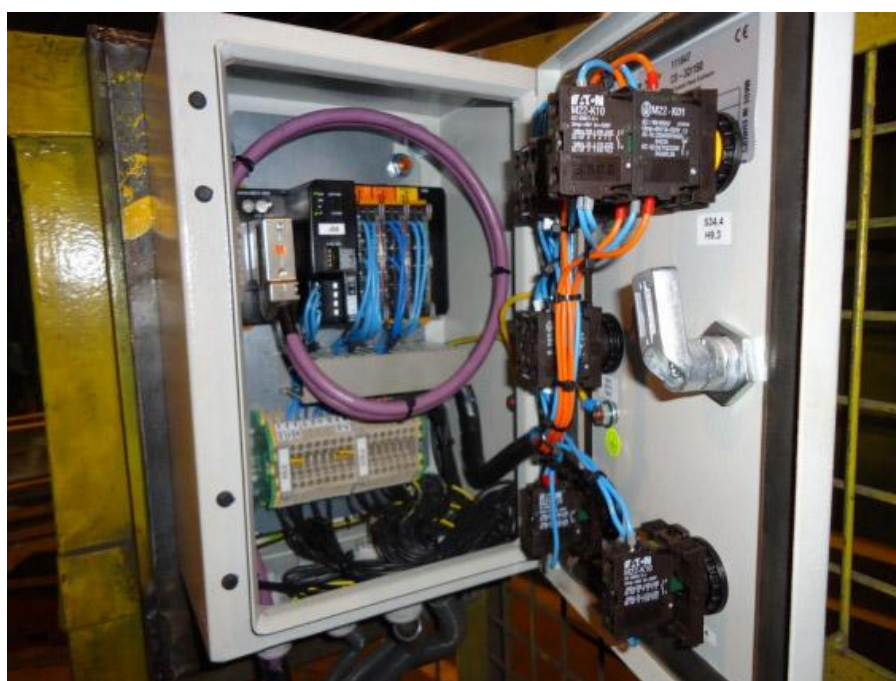
Zdjęcie 10 Pulpit sterowniczy transportera płytowego
