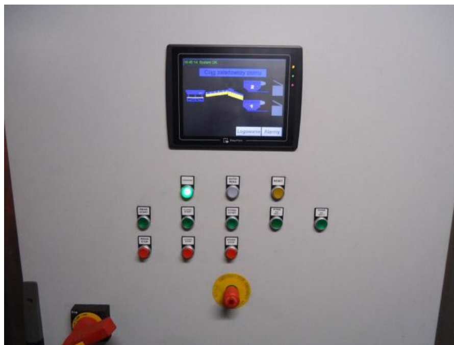
Zdjęcie 2 Widok panela operatorskiego.
