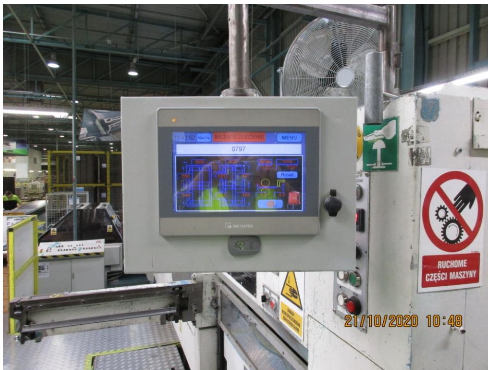
Zdjęcie 1. Widok głównego panela operatora.
